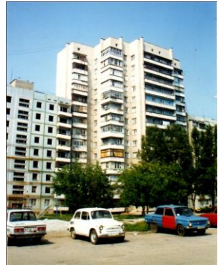
Рис. 1. Відселений аварійний 9-поверховий будинок через зіткнення із суміжним 14-поверховим будинком внаслідок зустрічних кренів
