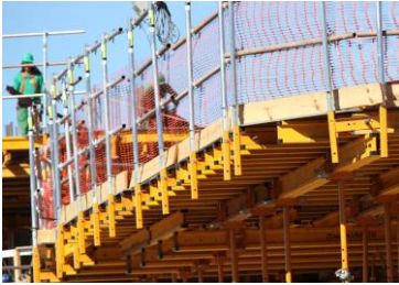
Рис. 4. Захисні бар'єри, встановлені на дерев'яних балках
