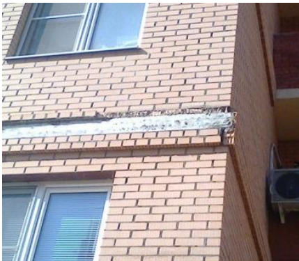
Рис. 3. Руйнування цегляної кладки в рівні розташування міжповерхових плит перекриттів
