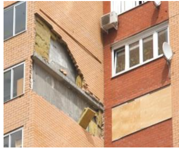
Рис. 2. Руйнування цегляної кладки внаслідок випинання
