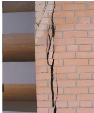
Рис. 4. Руйнування цегляної кладки на кутових ділянках
