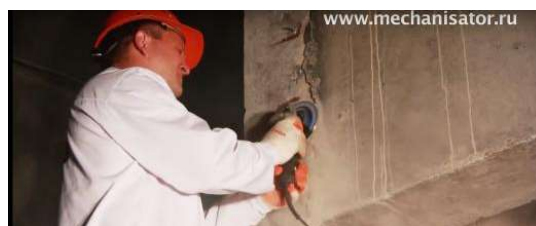
б – видалення напливів бетону
