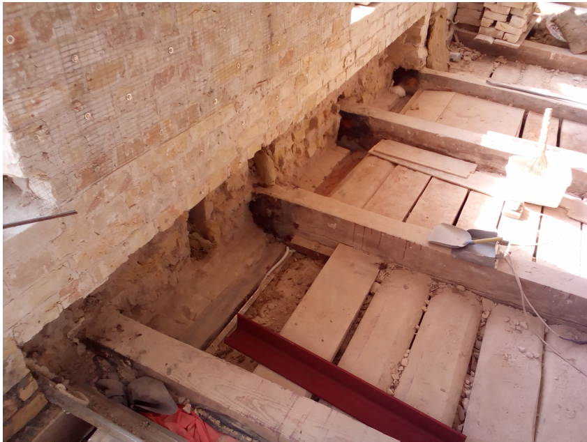
Рис. 1. Приклад влаштування ніш для балок підсилення перекриття, що призвело до суттєвого руйнування й відповідно до ослаблення стіни
