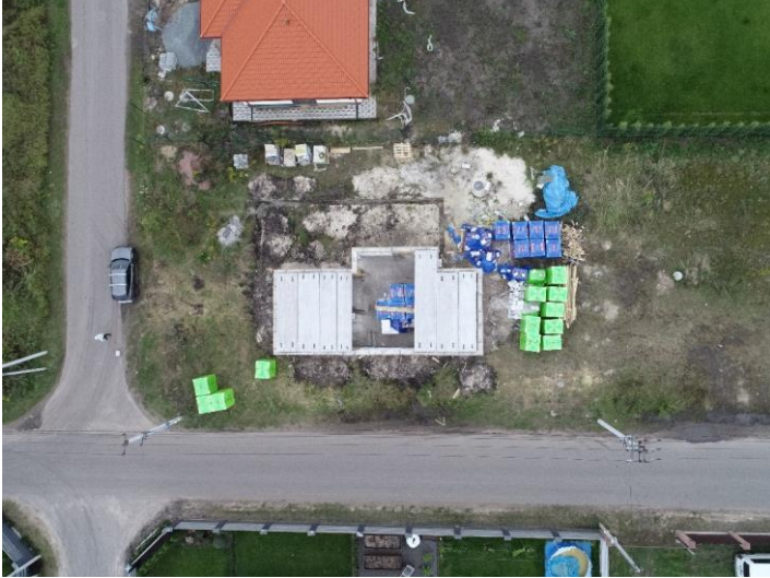
Рис. 4. Фотофіксація укладання збірних плит перекриття 1-го поверху котеджного будинку в КМ «Міжріччя» 25 вересня 2021 р.
