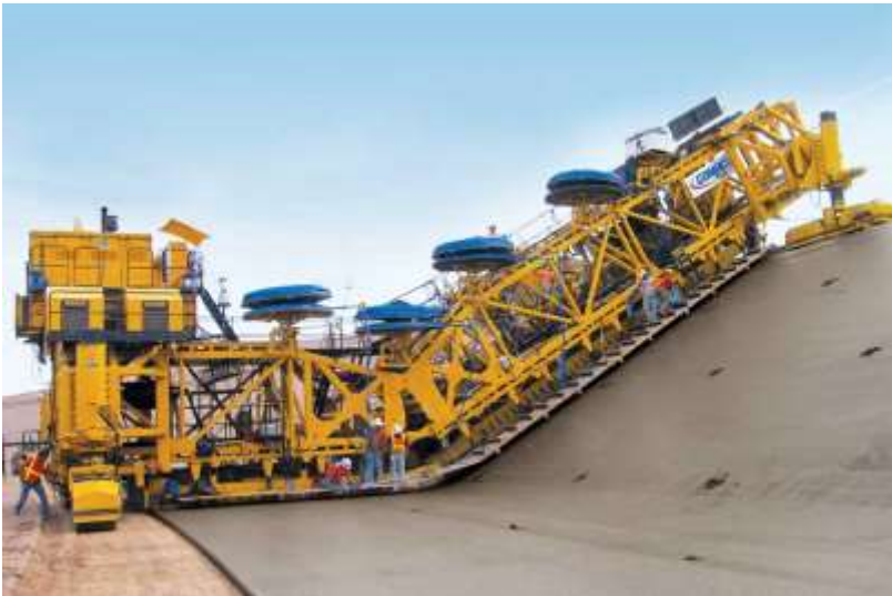
Рис. 4. Приклад ковзної опалубної системи для влаштування горизонтальних і похилих монолітних конструкцій із горизонтальним переміщенням формоутворювальних елементів [16]
