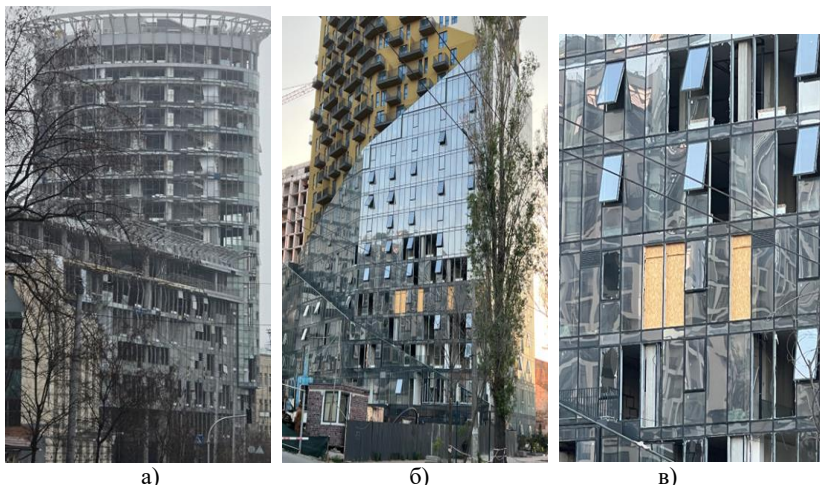
Рис. 10. Вид та ступінь пошкодження збірної системи з суцільним світлопрозорим фасадом із термоізоляцією плит перекриттів залежно від місця влучання вибухового елементу: а – безпосередньо у стіну; б, в – у межах від 25 до 50 м від фасаду *
