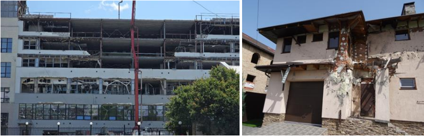
Рис. 1. Пошкодження будівель у наслідок військових дій*
